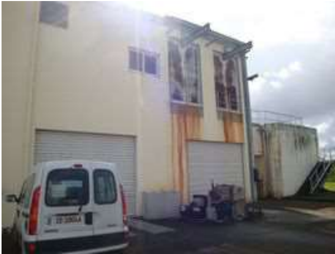
Figure 2.1 - Oxydation portes de prétraitement
