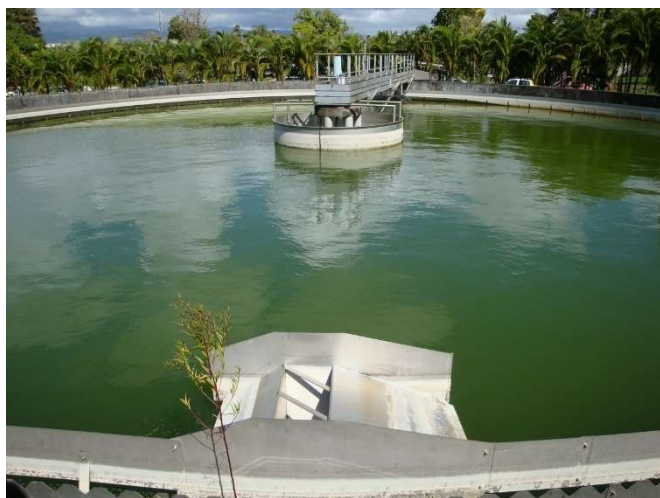
Figure 2.5 - Clarificateur, lame déversante
